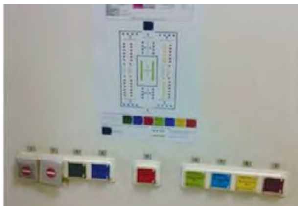
Инструкция на стене
